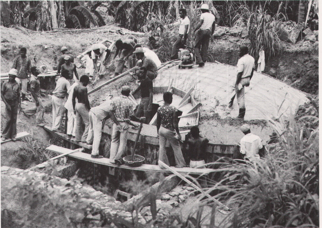
3 Helvetas: Aufbau dörflicher Wasserversorgungen in Kamerun. Betonieren einer Reservoir-Kuppel / Helvetas: établissement d'un ravitaillement en eau dans des villages au Cameroun. Voûte d'un réservoir en train d'être coulée.
