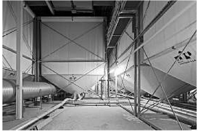
Materialsilos im Obergeschoss
