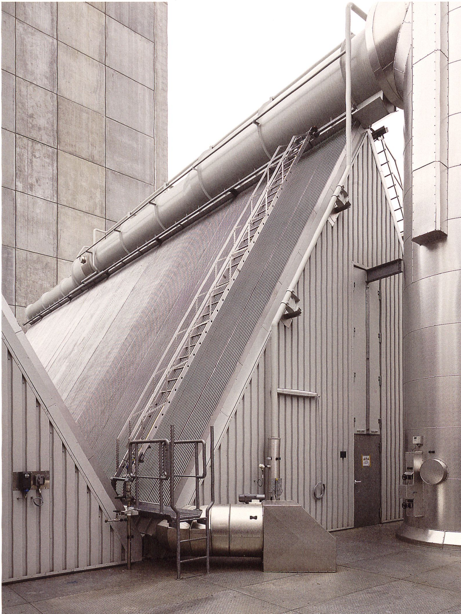
Anschauliche Technik ohne bildhafte Metaphern: Der heisse Dampf wird über steildachähnliche Luftkondensatoren geleitet und zu Wasser kondensiert.
