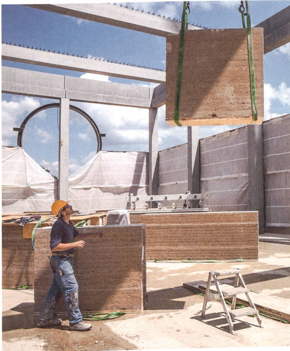
Vorfabrizierte Stampflehelemente stapeln sich vor dem Betonskelett. Ein Betonsockel und ein Wellblechdach schützen vor Feuchteintritt. Trasskalkschichten und zwei Armierungseisen stabilisieren die 11 Meter hohe Wand. Bilder: Iwan Baan, Herzog & de Meuron (links oben), Ricola
