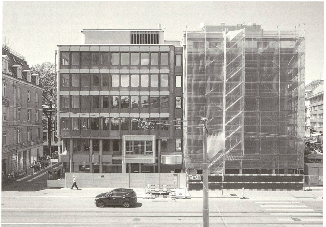
Architektonische Verwandlung des Danzas-Hauses in Zürich, erbaut 1976/77 von Burckhardt + Partner. Bild: Samuel Schälch
