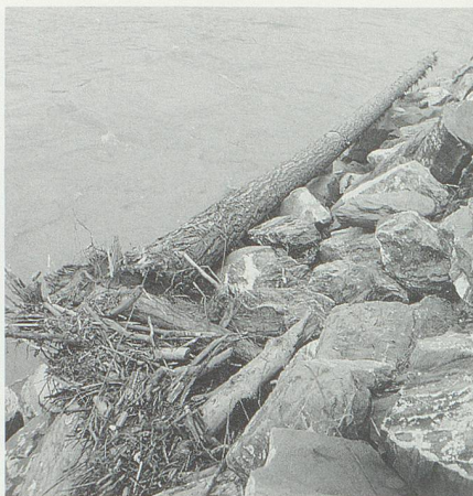
Nach dem Rückgang des Hochwassers: Eine mit Drahtseilen befestigte Föhre hängt in den Vorgrundsteinen.
