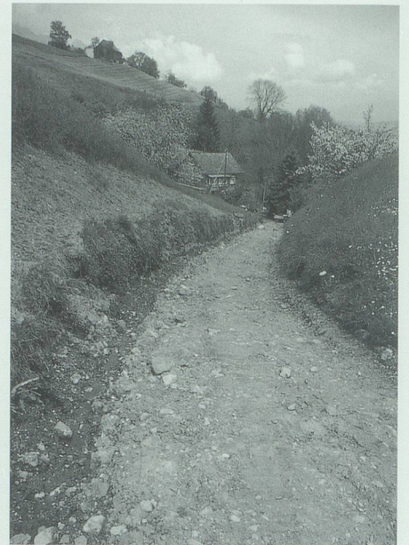
Im unteren Bereich der Chüegass sind die seitlichen Stützmauern infolge von Grabungsarbeiten verschwunden. Der Mangel an Zeit und Geld hat wohl dazu geführt, dass die Herstellung des ursprünglichen Zustandes unterlassen wurde. Bild 1998.
