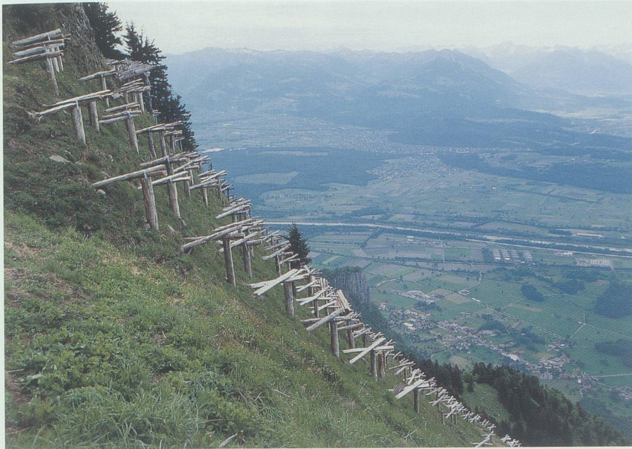
An den steilen Hängen des Sennwalder Berggebiets (hier am Stauberenfist) sind in den letzten Jahren als Gleitschneeschutz über 4200 Dreibeinböcke erstellt worden. Bild: Hans Jakob Reich, Salez.
