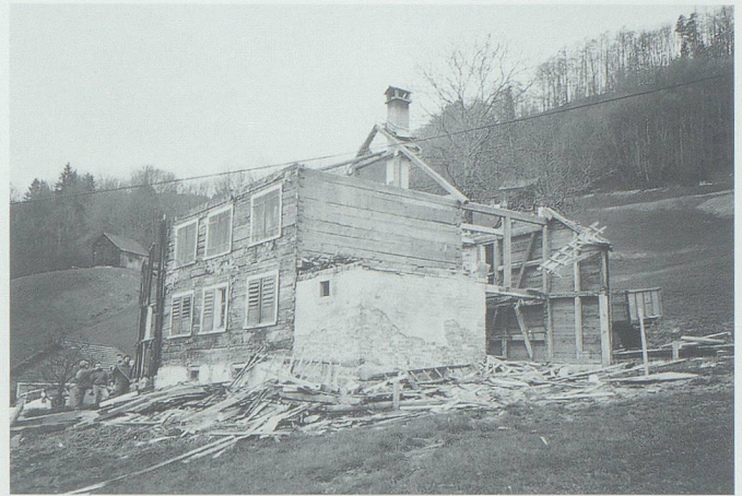
Sie tut schon etwas weh, diese «Operation». Der gestrickte Hauptbaukörper ist noch gut, der bergseitige Küchenanbau jedoch ist besonders im Sockelbereich sehr schlecht. Auch der sich im Vordergrund befindende gemauerte Schweinestall wird noch abgebrochen.
