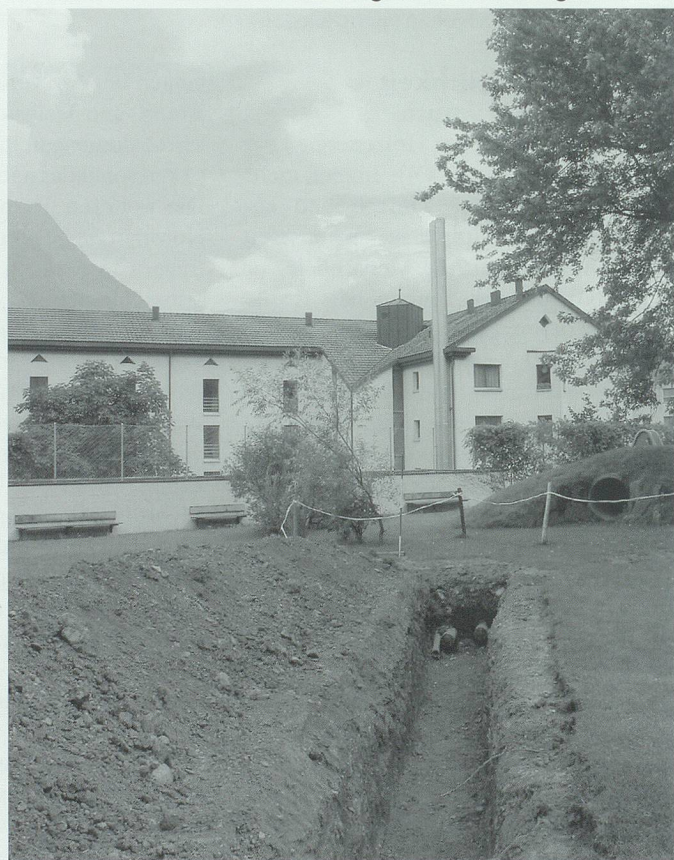
Verlegen der Wärmeleitung des Nahwärmeverbundes Azmoos. Die Heizzentrale (im Hintergrund) befindet sich im Gebäude der Alterswohnungen an der Feldgasse.
