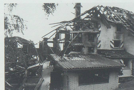
27. August: Ein Brand führt zur praktischen vollständigen Zerstörung des ehemaligen Durchgangszentrums Eichlitte in Gams.
