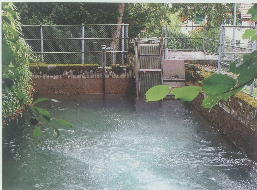
Das mehrmals sanierte Reservoir der Elektrokorporation Oberschan beim einstigen Badeck am Mülbach: Falsche Berechnungen des Vorgängerbaus führten 1909 zu Schäden, Bauverzögerungen und vielen unangenehmen Umtrieben für die Kommission.
