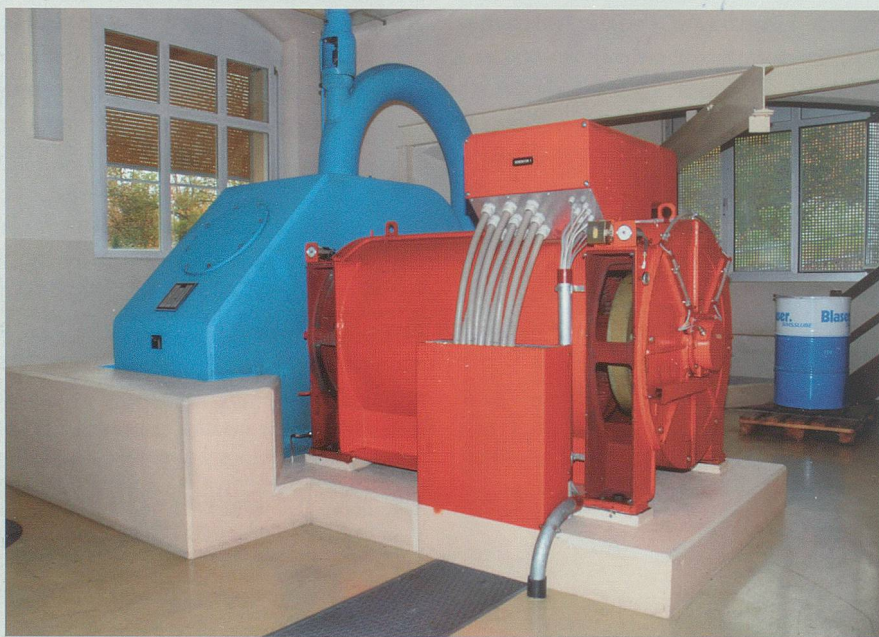
Die jüngste der beiden heutigen Maschinengruppen des EW Sennwald, die zusammen eine Wirkleistung von 920 kW erbringen und bis zu einem Drittel der in den Dörfern Sennwald, Salez, Lienz und Plona verbrauchten Elektrizität produzieren.
