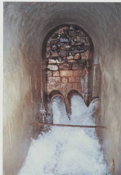
Stollenfassung des EW Sennwald: Fast dreissig Meter tief im Berg wird der Abfluss der beiden Alpsteinseen gefasst. Foto EW Sennwald
