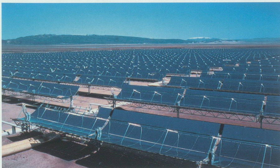
Spiegelrinnenkraftwerk in Kalifornien/USA. Public-Domain-Bild
