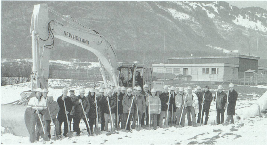
28. November: Mit dem Spatenstich wird die Erneuerung und Erweiterung der ARA Sennwald in Angriff genommen.
