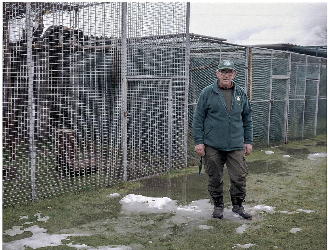
31.1.2021: Mehrere Adler- und Geiergehege konnten dem Gewicht der massigen Schneedecke nicht standhalten und brachen ein. Durch eine erfolgreiche Spendensammlung konnte es bald schon an die Reparatur der Gehege gehen.
