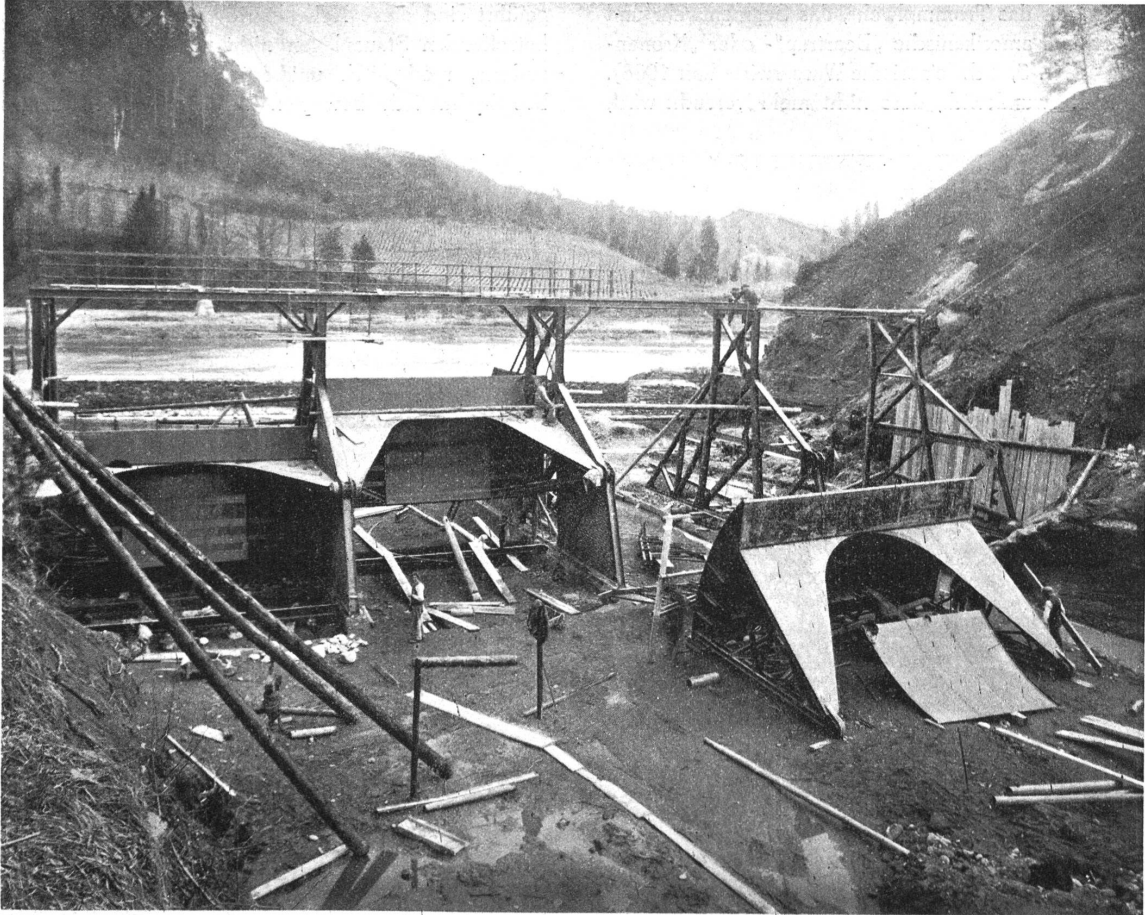
Abbildung 2. Segmentschützwehr bei Hauterive (Freiburg).
