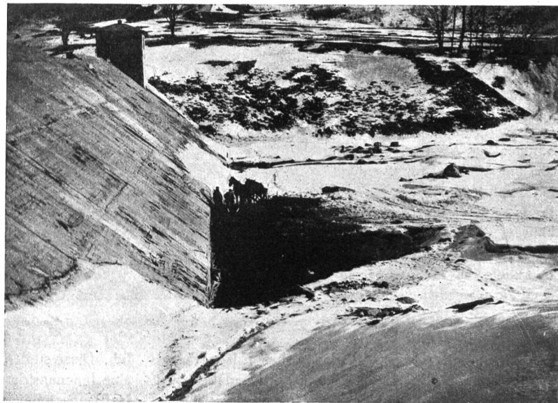
Abbildung 8. Pittsfield-Staudamm nach der Unterspülung, von der Wasserseite gesehen.
