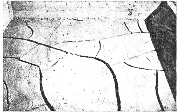
Abb. 11. Betontrog. Risse in noch feuchtem Lehm.
