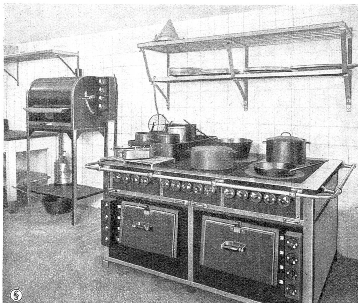
Abb. 4. Elektrischer Grill und Herd in der Nebenküche der Rheinparkterrassen in Köln.
