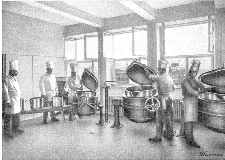
Abb. 2. Elektrische Kippkessel mit 250–400 Liter Inhalt in den Rheinparkterrassen in Köln.
