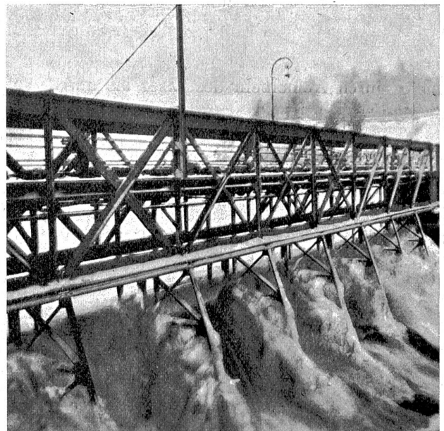
Abb. 8. Elektrizitätswerk Wynau. Vereisung des Wehres. 17. Februar 1929.
