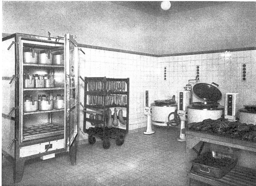
Abb. 47 Metzgerei-Anlage A. Lobsiger-Mathys, Bern Ausgeführt von Gebr. Grob, Zürich 4
