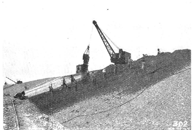
Abb. 6. Kraftwerk Klingnau. Linksseitiger Stausedamm unterhalb Gippingen, Wasserseite. Einbringen und Verteilen des Lehmes für die Dammabdichtung mittelst Greifer und Handarbeit auf der Böschung als Vorbereitung für die Walzung.
