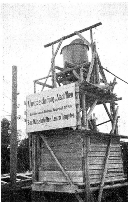
Abb. 5 Reservoir im Lainzer Tiergarten, Teil der Aufbereitungs- und Betonieranlage.
