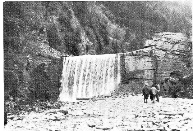
Abb. 16 Sperre III an der Nolla aus dem Jahre 1903. Zustand 1937. Fortschreitende Zerstörung durch seitlichen Bergdruck vom linken Ufer her. Eidg. Oberbauinspektorat.
