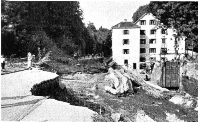
Abb. 5 Die Ausdrümmung als Folge des Dammbruches im Tiefenhof (s. Abb. 4).
