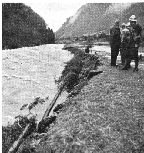
Abb. 5 «Balm» (km 0,500). Anriss rechtsufrig.
