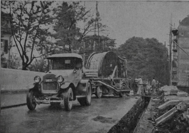
Verlegung von 6-kV-Kabeln 3 \times 240 \text{ mm}^2 für das Elektrizitätswerk der Stadt Bern.
