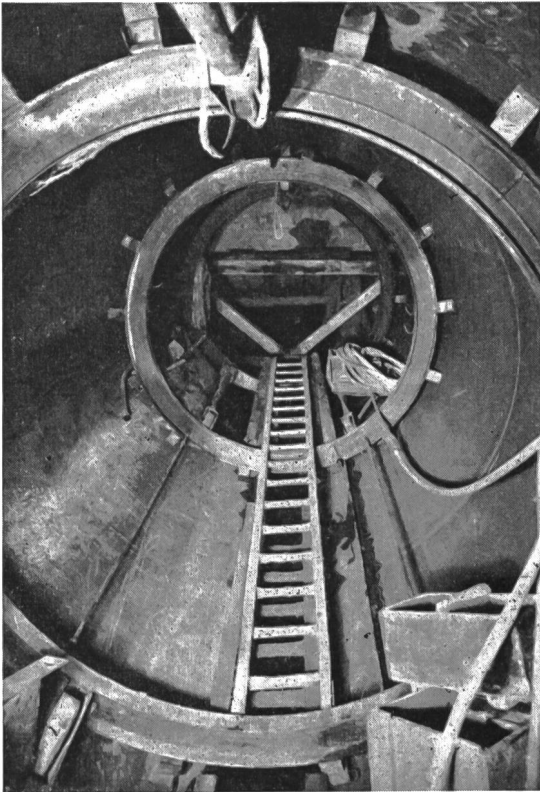
Abb. 6 Kraftwerk Innertkirchen. Druckschacht. Panzerung mit Aussteifungsringen. (Phot. Brügger A.-G., Meiringen)
