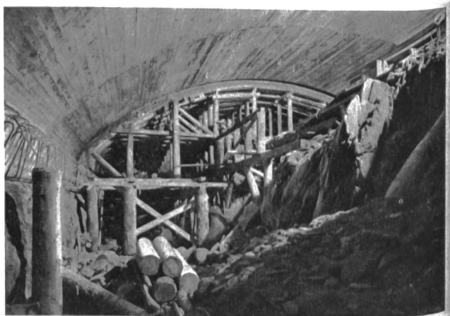
Abb. 9 Kraftwerk Innertkirchen. Ausbruch der Kalotte für die Zentrale mit Gewölbebetonierung. (Phot. Brügger A.-G., Meiringen)
