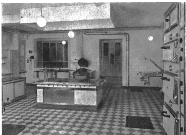
Fig. 62 Teilansicht der elektrischen Küchenanlage des Sanatoriums Sanitas, Davos. Vue partielle de la grande cuisine électrique du Sanatorium Sanitas, Davos.
