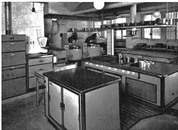
Fig. 69 Teilansicht der Elektroküche (Fabrikat Salvis). Vue partielle de la cuisine électrique (Marque Salvis).
