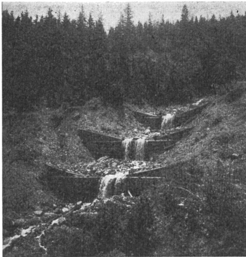
Abb. 5 Typisches Detailbild der Sperren am Casolf-Wildbach mit noch zu stark verwässerten, rutschenden Tobelhängen. Die Sperrenbauten sind daher von Rutschmaterial schon stark überladen.
