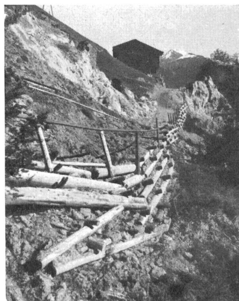
Abb. 24 Fahrstrasse bei Caluonia (Schuders). Die Strasse im Holzkastenbau sackt hier auf einer Strecke von ca. 50 m täglich um einige Zentimeter ab. Photo Dr. Stauber.
