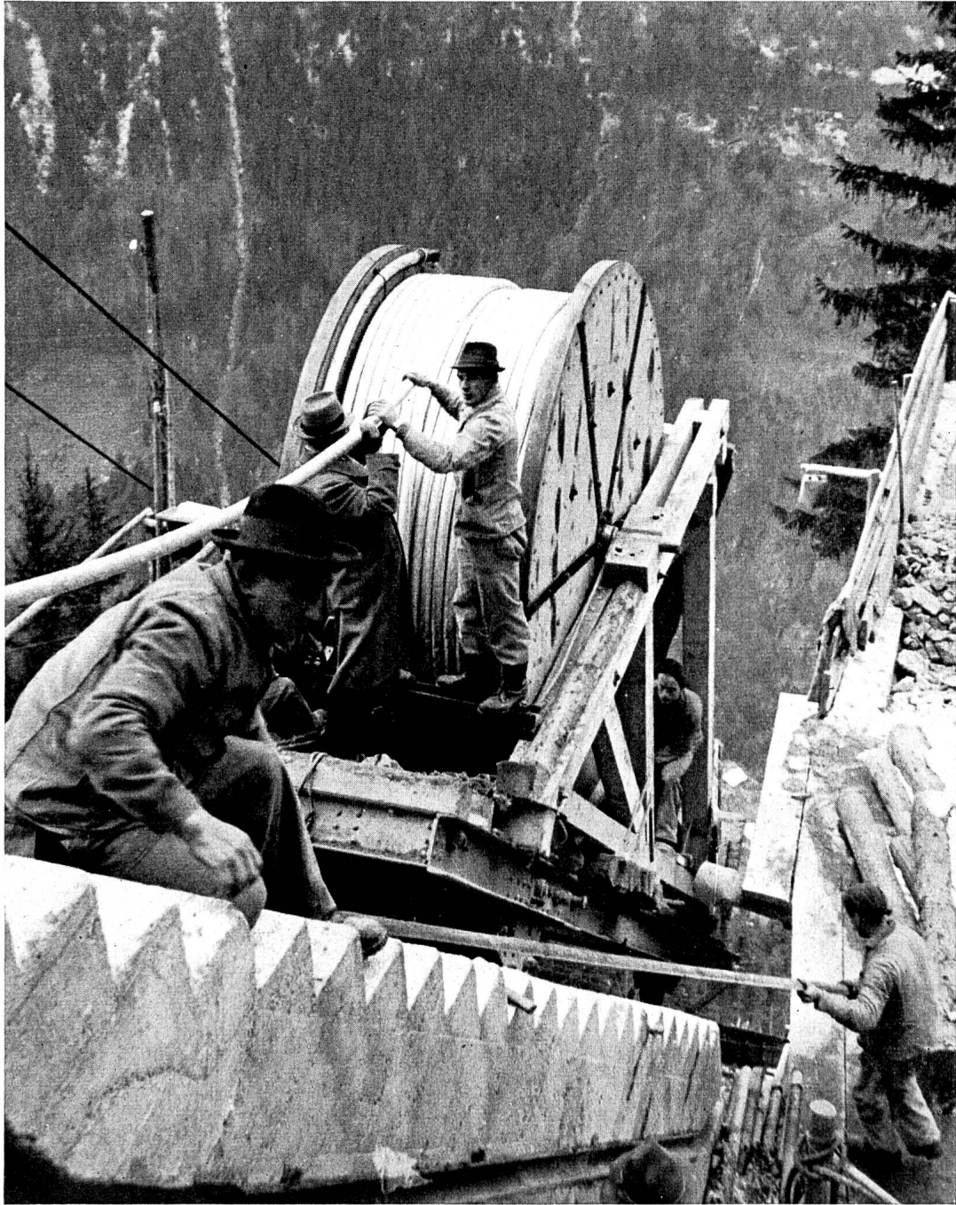
GRIMSEL Verlegung des Dreibleimantelkabels Urweid-Wasserschloss 3 x 1 x 16 mm 2 , 16 kV. Länge 1065 m. Höhenunterschied 630 m
