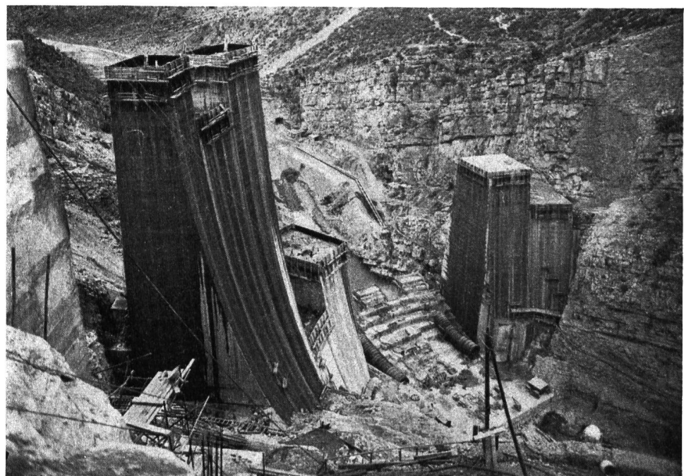
Fig. 7 Barrage de Bin el Ouidane. Vue prise de l'aval le 10 sept. 1951: bloc 13 à la cote 803,00; conduites forcées des blocs 5 et 7 en cours de montage. (Photo Gillot - Casablanca)
