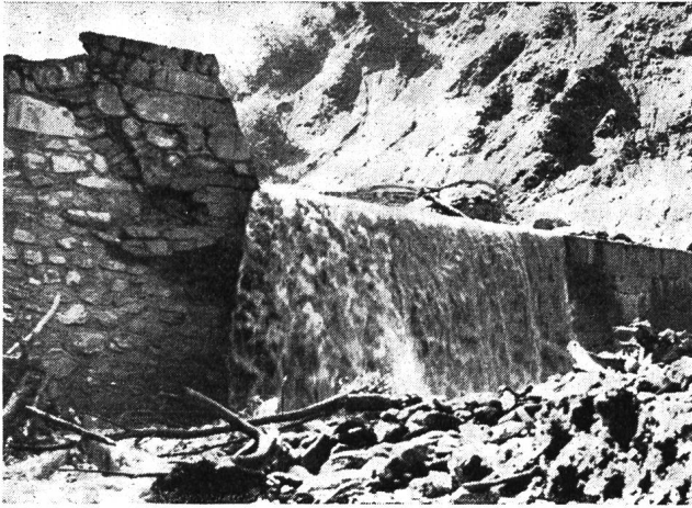
Abb. 7 Nollatobel. Zerdrückte Quersperre infolge des Bergdruckes vom Heinzenberghang her (im Bild von rechts). Zustand am 11. 8. 1952
