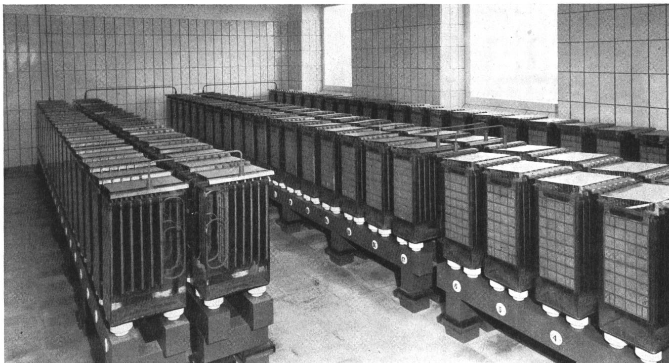
Batterieanlage im Kraftwerk Birsfelden
