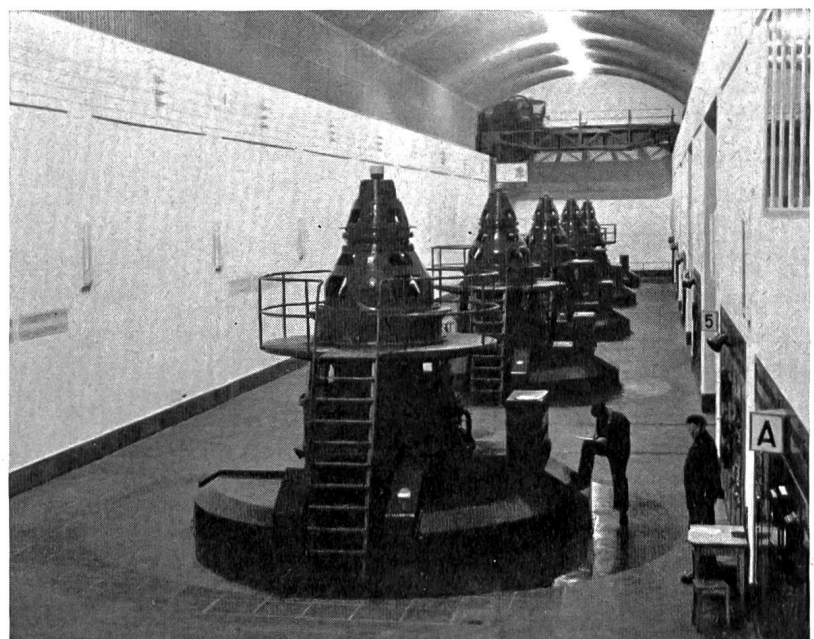
Abb. 2 Zentrale Innertkirchen, die erste, 1940/42 gebaute Kavernenzentrale der Schweiz; Aufnahme nach dem Einbau der 5. Maschinengruppe im Mai 1952 (Photo O. E. Gerber, Uerikon)
