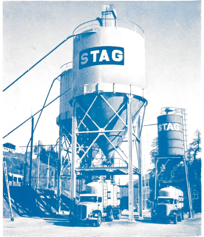
Umschlagsanlage der STAG in St. Moritz
