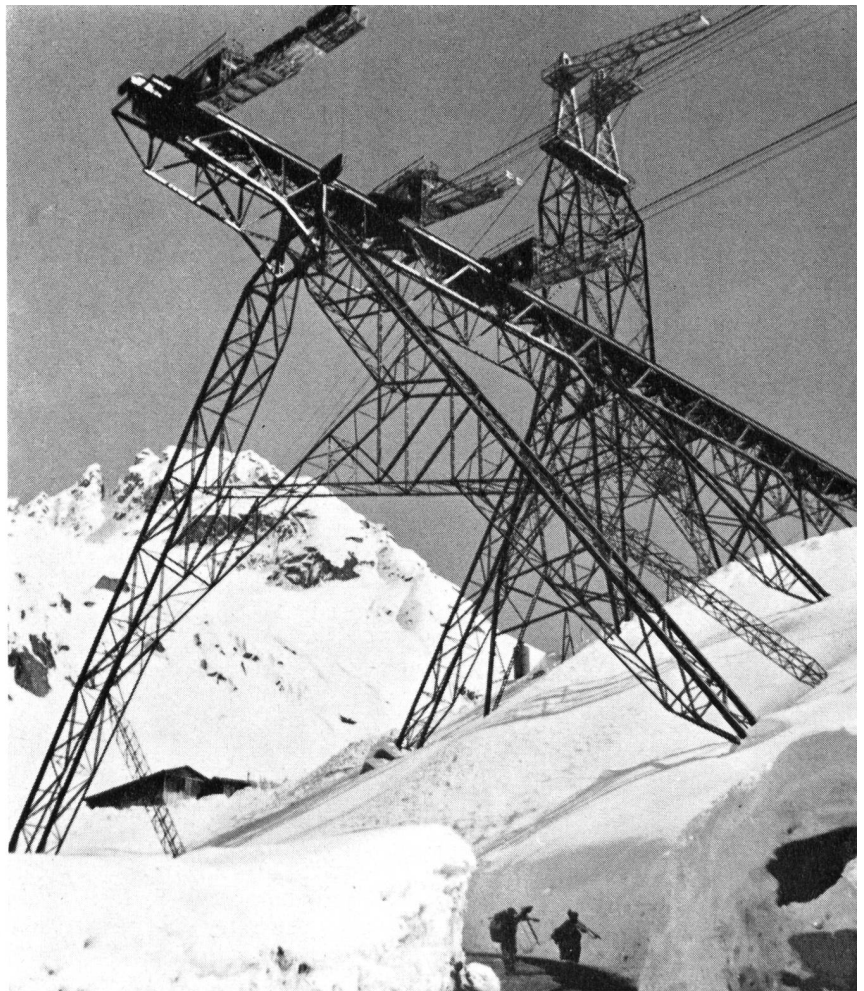
Bild 7 Staumauer Albigna: 3 parallel fahrbare Krane mit Gegenwagen auf großer Brücke; Gewicht der Eisenkonstruktion 290 t. Fester Kran auf etwa 75 m hohem Turm für die Betonierung der obersten Mauerpartie; Gewicht des Turmes 77 t
