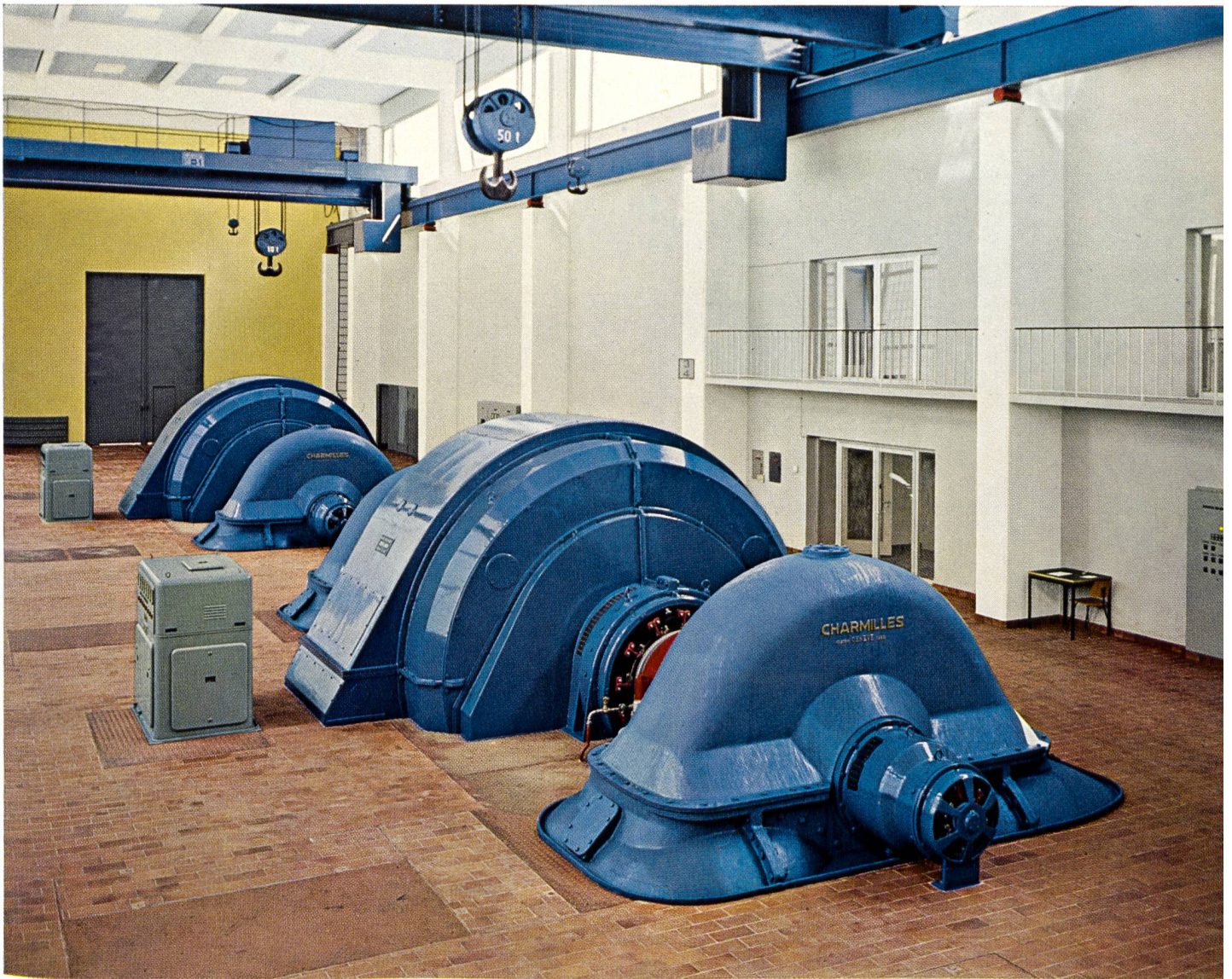
Inneres der an der Mattervispa 1958/59 in Betrieb genommenen Zentrale Ackersand II der Aletsch AG. Seit etwa zehn Jahren werden die Maschinenhäuser auch in der Schweiz farbenfreudiger gestaltet. (Photo R. Spreng, Basel; Clichés der Lonza AG, Basel)
