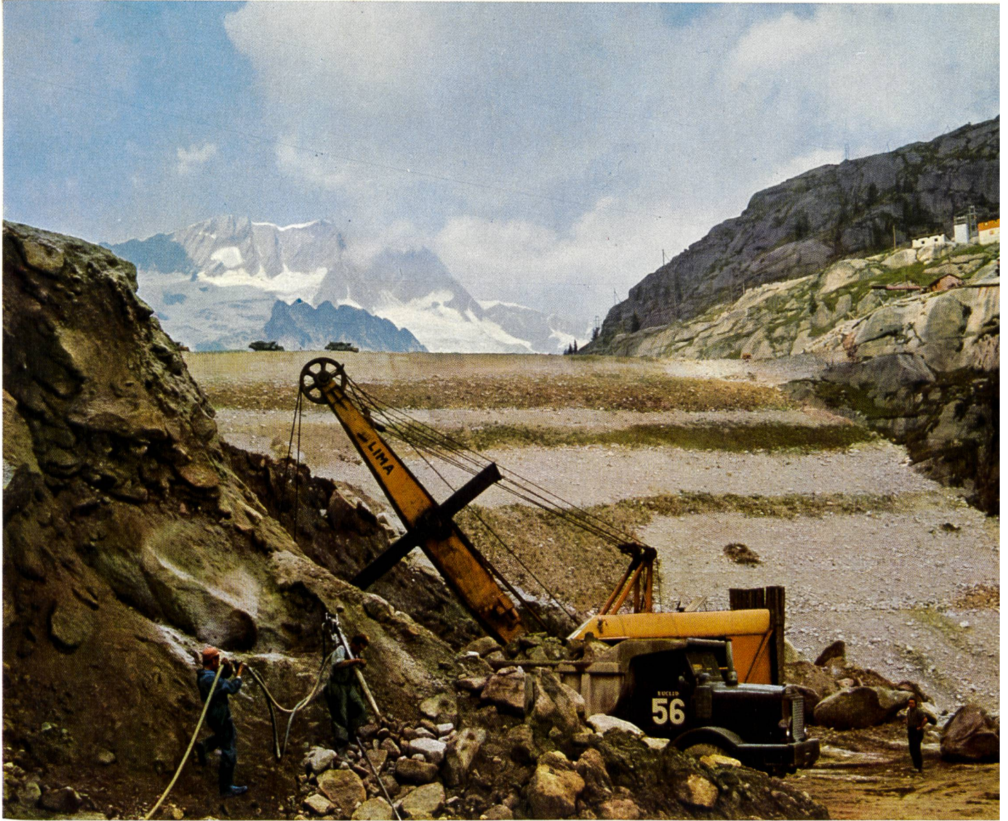
Bauarbeiten für den 155 m hohen Steindamm auf der Göschenalp, der 1960/61 vollendet wird; im Hintergrund Dammastock-Schneestock (Photo G. Leiser, Zürich; Clichés der Elektro-Watt AG, Zürich)
