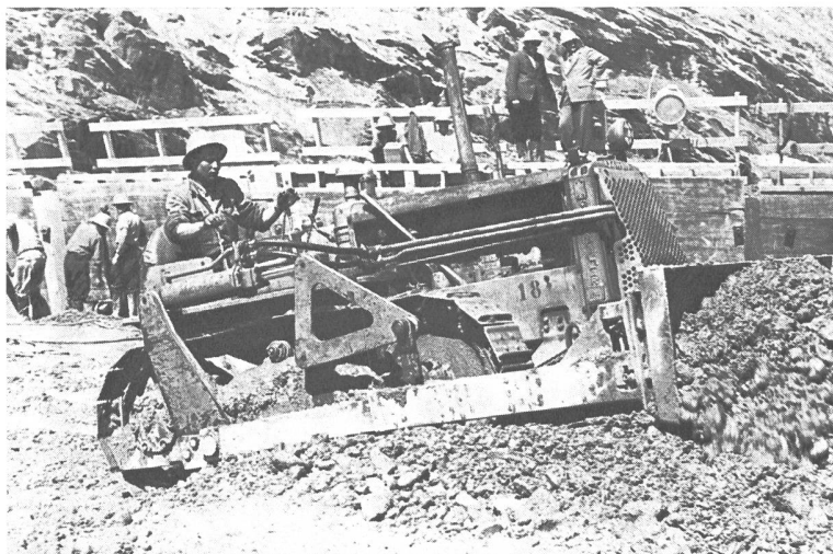
Fig. 2 Epandage du béton par bulldozer — Betonausbreitung mit der Planierdraupe Spreading of the concrete by bulldozer
