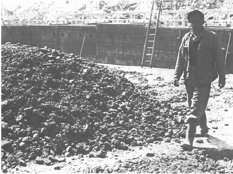
Fig. 4 Tas de béton après déchargement Betonhaufen nach Entleerung aus dem Betonkübel Concrete pile after discharge from the bucket
