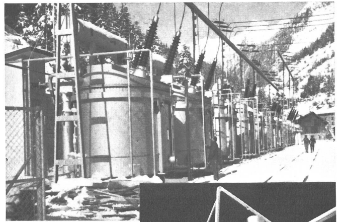
Zentrale von Göschenen Brandschutz-Anlage mit Wassernebel
