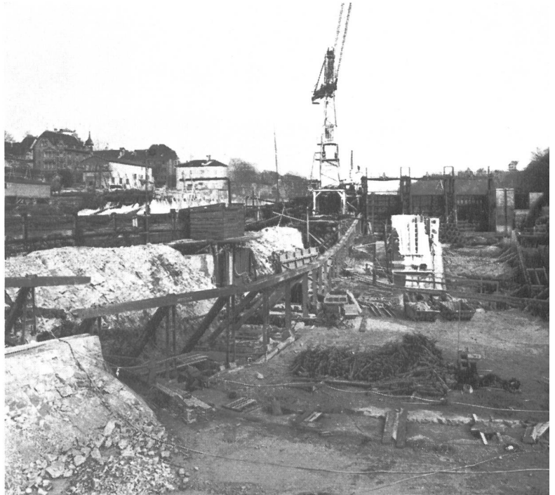
Bild 9 Baugrubenabschluß mit der Stützkonstruktion für die Spundwand; im Hintergrund das Hilfswehr. Aufnahme vom 21. Februar 1961
