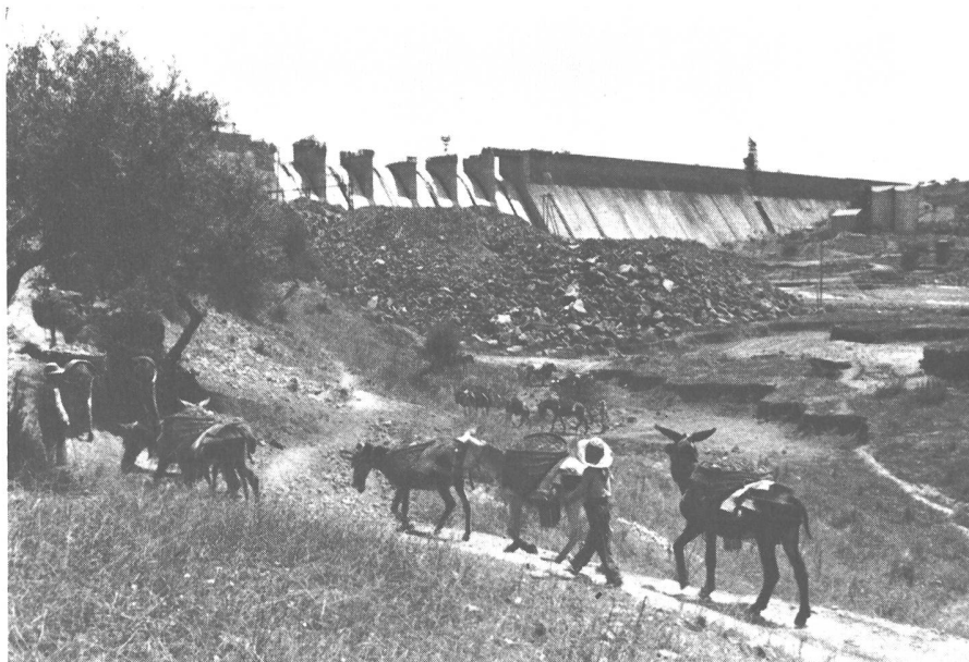
Bild 59 Esel und Maultiere, die nützlichsten und genügsamsten Nutztiere der Mittelmeerzone werden hier kolonnenweise sogar noch für den Sand- und Kiestransport bei einer modernen Großbaustelle eingesetzt (Staumauer Orellana)
