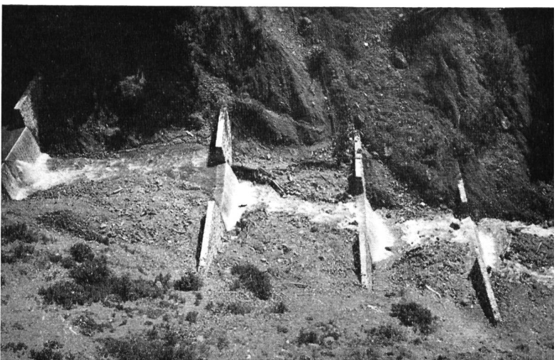
Bild 4 Sperren im Durnagelbach, Zustand im August 1954
