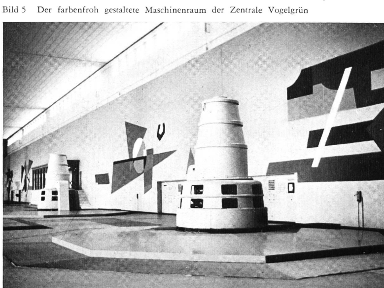
Bild 5 Der farbenfroh gestaltete Maschinenraum der Zentrale Vogelgrün
