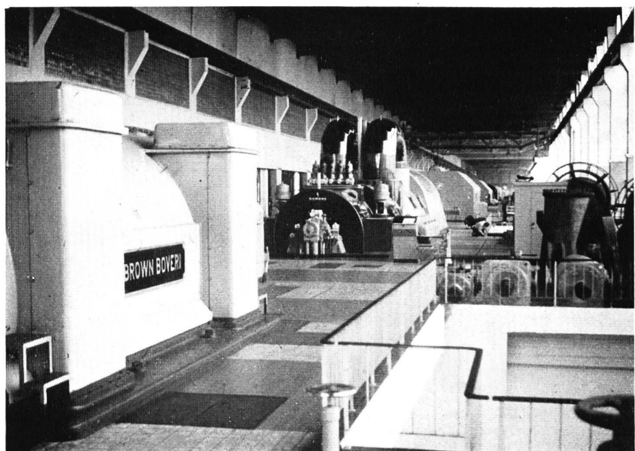
Bild 71 Blick in die riesige Maschinenhalle des Braunkohlenkraftwerks Frimmersdorf II des RWE im rheinischen Industriegebiet
