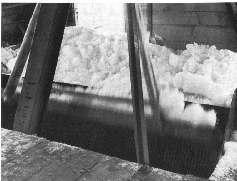
Stationäre, automatische Rechen- reinigungsmaschine bei der Arbeit bei grossem Grundeisanfall
