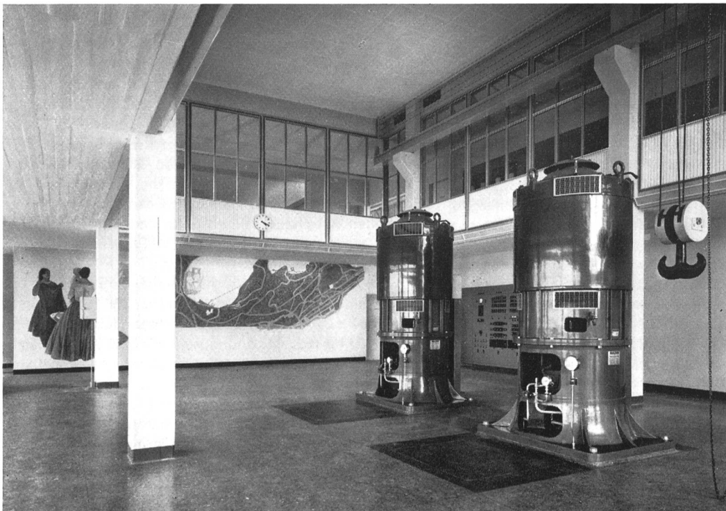
Fig. 3 Maschinensaal mit zwei 1040 PS Vertikalmotoren in der Filteranlage Lengg des Seewasserwerkes II der Stadt Zürich (Photo H. Wolf-Benders Erben, Zürich)
